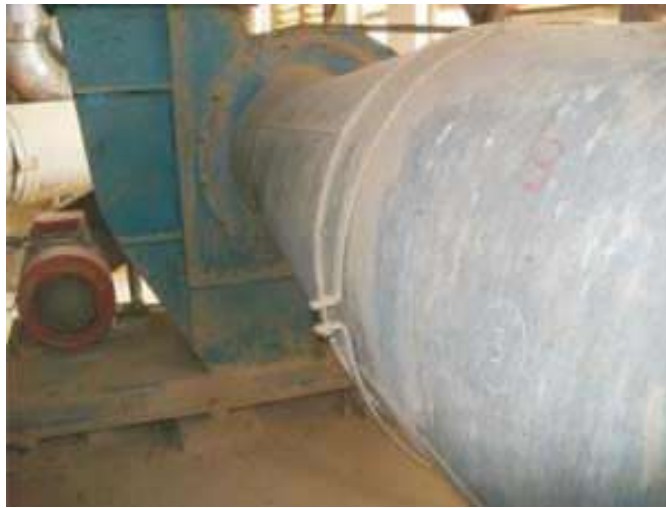
Fig. 6.8. ID Fan Inlet (Port Hole 8) on 4 th Floor
